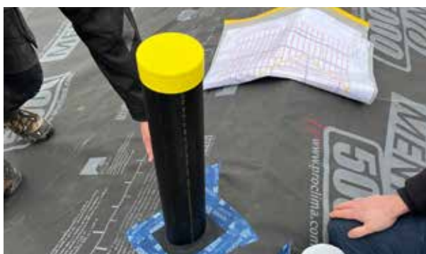
... et de tuyaux de ventilation (ROFLEX 100).
